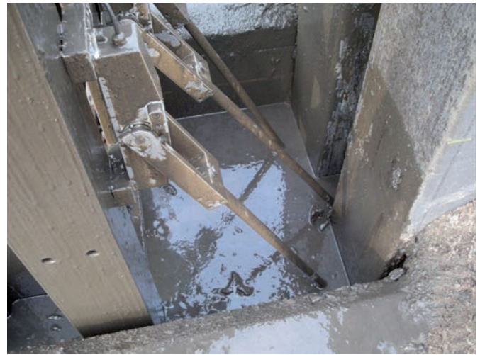
Bild 9 Messarme bei der Vermessung einer Stahlflachfuge Distance sensors measuring a lost steel stop end
