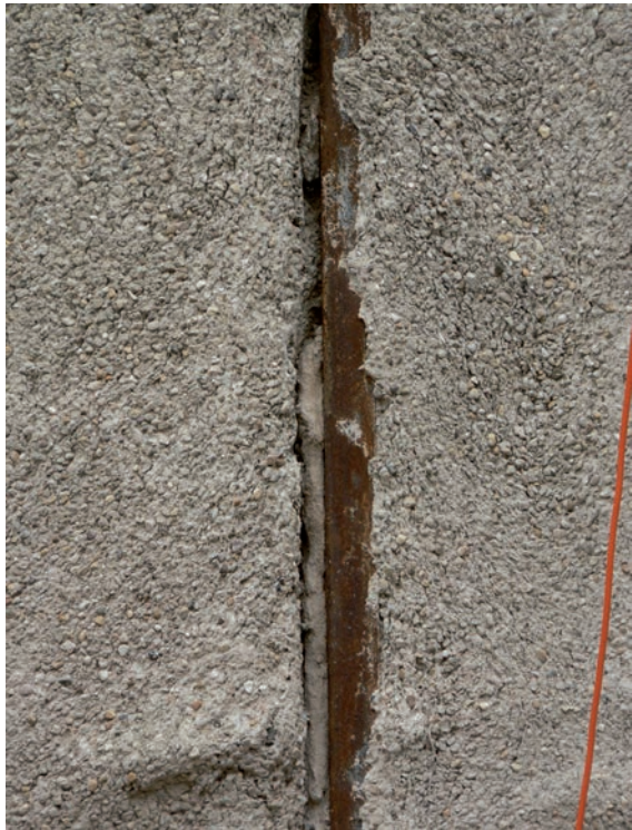
Bild 3 Umlaufbeton in einer Schlitzwandfuge Exposed joint with excess concrete
