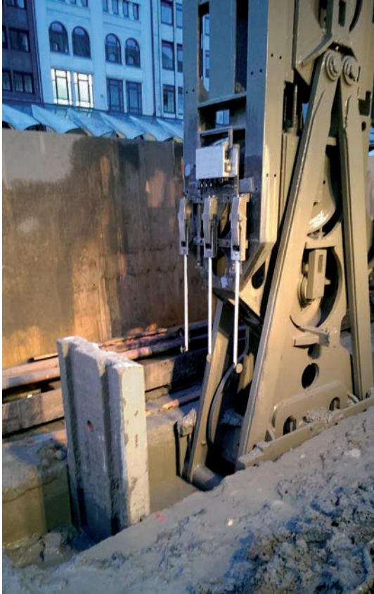
Bild 8 Der Fugeninspektor montiert am Schlitzwandgreifer The Joint Inspector mounted to the grab
